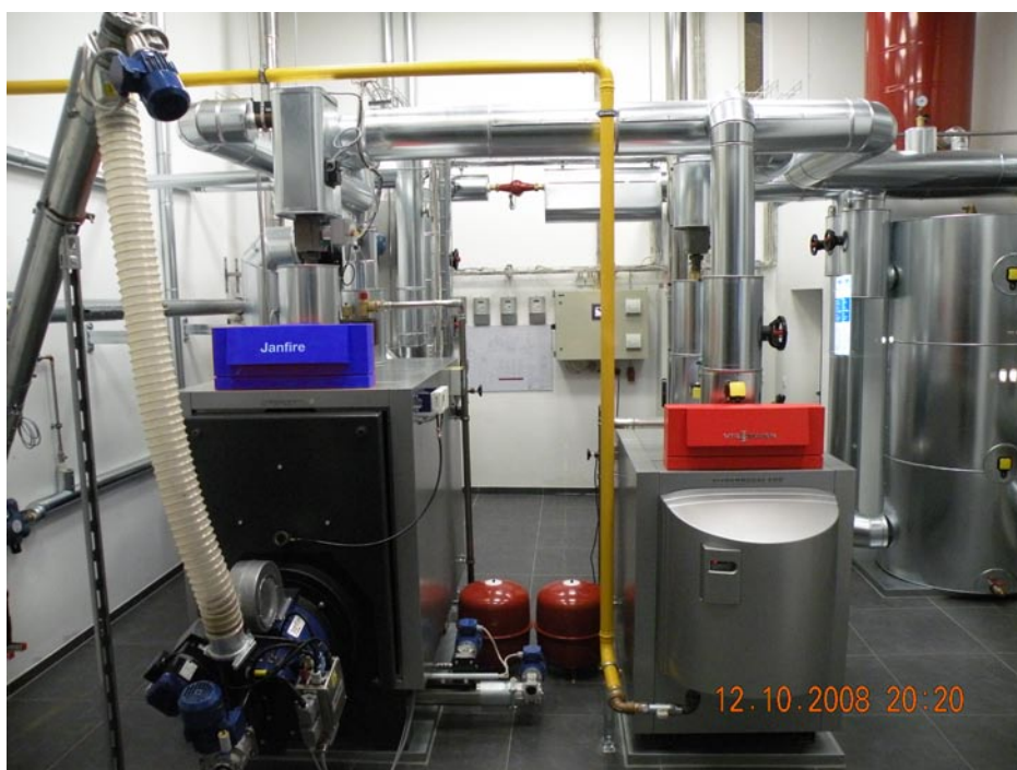
Referenzanlage 2 (150 kW Pellets + Gas)
